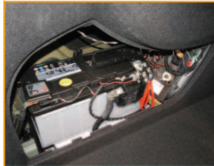
12V-Batterie im Kofferraum mit Hauptsicherungsbox Bei Verbau der 12V-Batterie im Kofferraum entfällt die 12V-Batterie im Motorraum.
